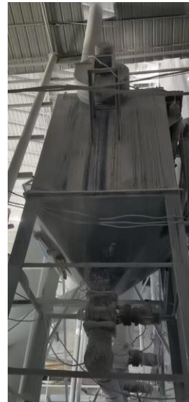
除尘器及排气筒
